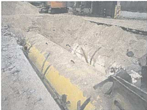
Foto 12: Die Tanks 1 und 2 sind ebenfalls freigelegt. Auch hier wurde ausschließlich gelbbrauner Bausand ausgebaut.
